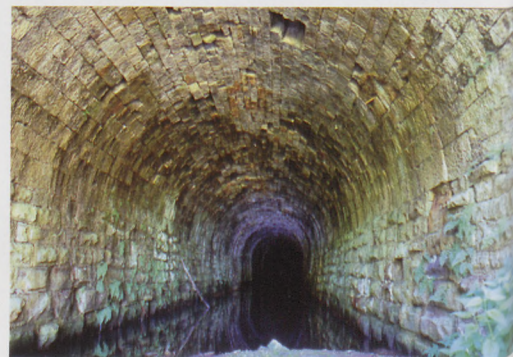
■ Interior inundado del túnel del Manquillo, sin restaurar. Era el punto a mayor altitud de la línea
