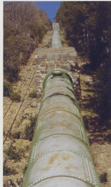
■ Un valle de funiculares y tuberías. Aquí la instalación de Molinos
