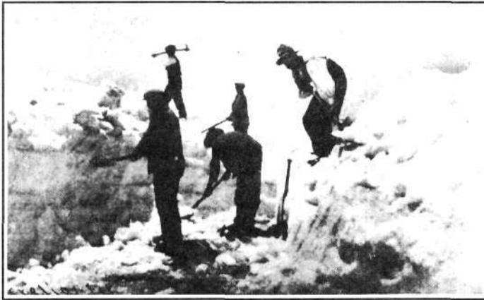
Una brigada de obreros abriendo el paso en la carretera de Sierra Nevada -la más alta de Europa- en las cercanías del picacho Veleta.
